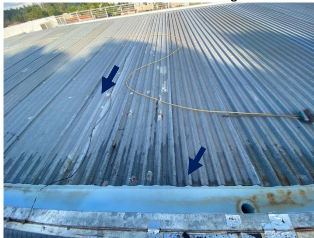
a) Telha com ferrugens, falta de fixação e falta vedação entre telhas.
