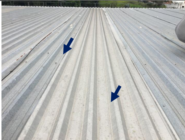
a) Telha com ferrugens, falta de fixação e falta vedação entre telhas.
