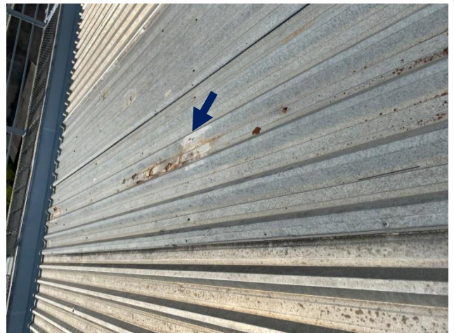
b) Telha com ferrugens, falta de fixação e falta vedação entre telhas.
